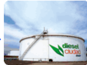
Planta de Almacenamiento
